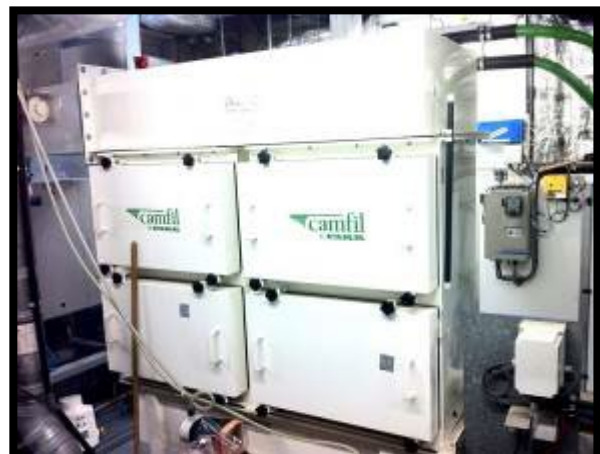
Figuur 16: Actieve koolfilters op een ventilatiesysteem voor uitstoot via de schoorsteen
