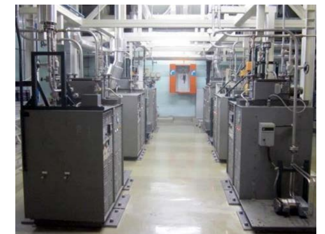
Toestellen voor de permanente controle van de gasvormige uitstoot in de kerncentrale van Tihange
