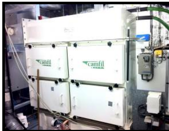
Figuur 16: Actieve koolfilters op een ventilatiesysteem voor uitstoot via de schoorsteen
