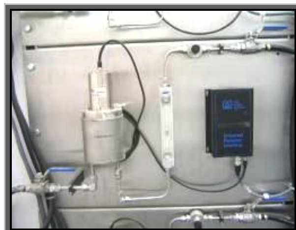
Figuur 13: Toestellen voor de permanente controle van de gasvormige lozingen in de inrichting Beta Plus Pharma te Brussel
