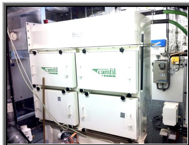
Figuur 12: Actieve koolfilters op een ventilatiesysteem voor uitstoot via de schoorsteen
